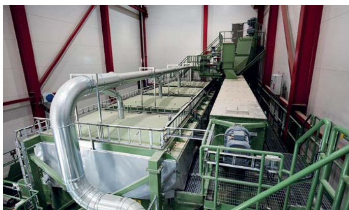
Instalacja 4 x SH 11-4
