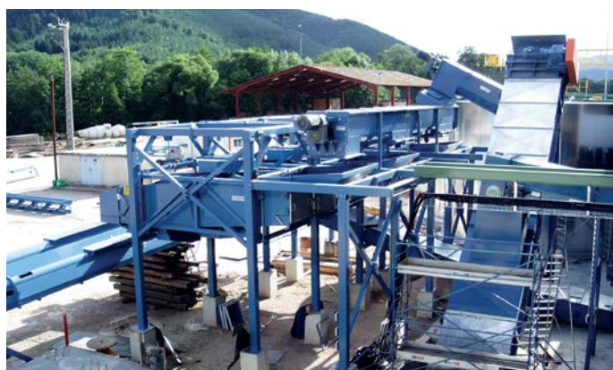
Instalacja 3 x SH 11-4
